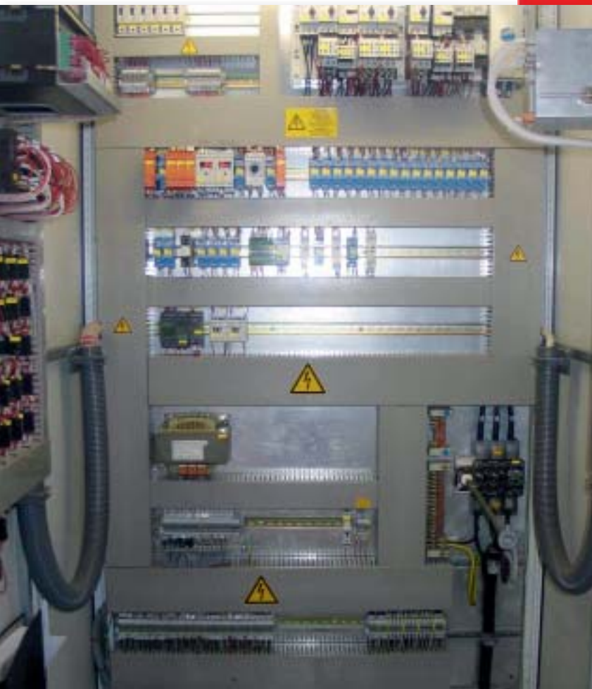
Bild 4: Die Regelung des Ofens. Die Verdrahtungen der einzelnen Bauteile und die Funktion der Regelinstrumente wurden überprüft.
