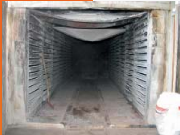
Bild 1: Der Trockenofen war ausgebrannt. Die intensivsten Schäden zeigten sich im vorderen Bereich.
