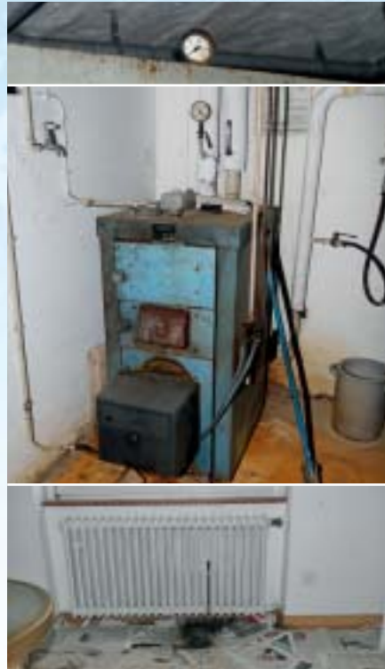
Bild 2 | Im Keller des frostgeschädigten Gebäudes stand ein nicht betriebsbereiter, alter Ölheizkessel, der nebenan stehende Öltank war leer. Im Obergeschoss war der Heizkörper des offenen Heizungskreislaufes geplatzt und halb leer gelaufen.
