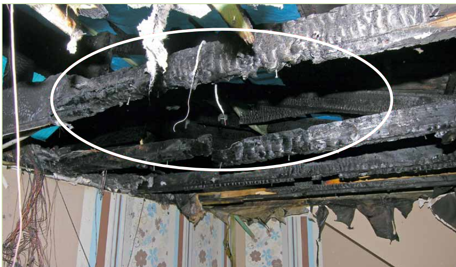
Bild 3 | Blick auf den Schadensschwerpunkt (Kreis).
