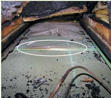
Bild 4 | Die verfärbte Holzlatte (Kreis) unter der Deckenheizung im Badezimmer nach der Entfernung des Heizelementes und der aufliegenden Mineralwolle.
