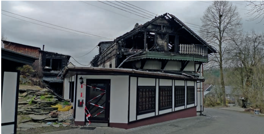
Bild 1 | Das durch den Brand zerstörte Gebäude
