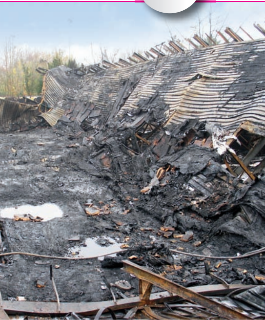
Bild 5 | Die Turnhalle ist vollständig niedergebrannt.
