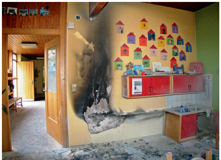
Bild 9 | Insbesondere in sensiblen Bereichen, wie hier in einem Kindergarten, ermitteln die IFS-Gutachter den Umfang des Brandfolgeschadens und entwickeln geeignete Sanierungsmaßnahmen.
