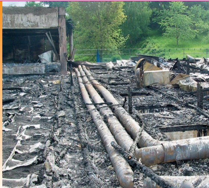
Bild 7 | Der Schaden- schwerpunkt: Hier hat sich ehemals das Satteldach befunden.
