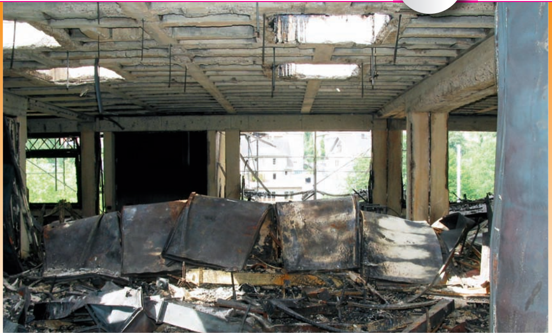
Bild 8 | Durch die Lichtkuppeln konnte sich der Brand in die Schule ausweiten.
