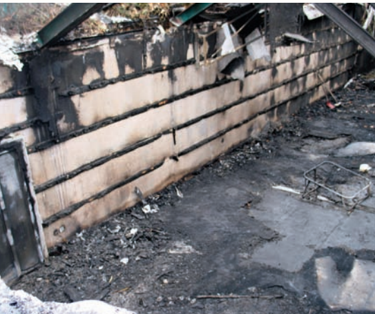
Bild 6 | In diesem Bereich der Turnhalle befand sich der Brandschwerpunkt. Ein technischer Defekt konnte als Brandursache ausgeschlossen werden.
