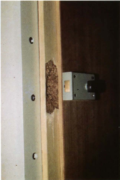
Bild 3: Kastenschlösser können als Zusatzschlösser genutzt eine gute mechanische Sicherungsmaßnahme darstellen. Werden jedoch die Schließkästen nur mit kurzen Holzschrauben befestigt, kann davon kein Sicherheitswert erwartet werden.
