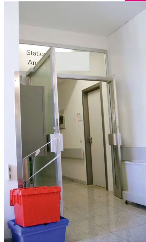
Bild 1 | Unzulässig offen gehaltene Tür älterer Bauart
