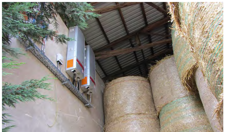
Bild 4 / Wechselrichter in der Nähe brennbarer Materialien
