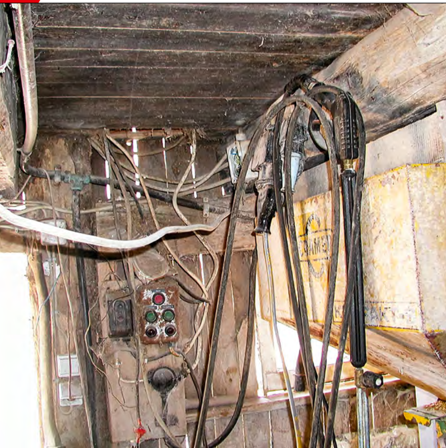
Bild 2 / Wildwuchs in der Installation kann leicht zu einem Großschaden führen.
